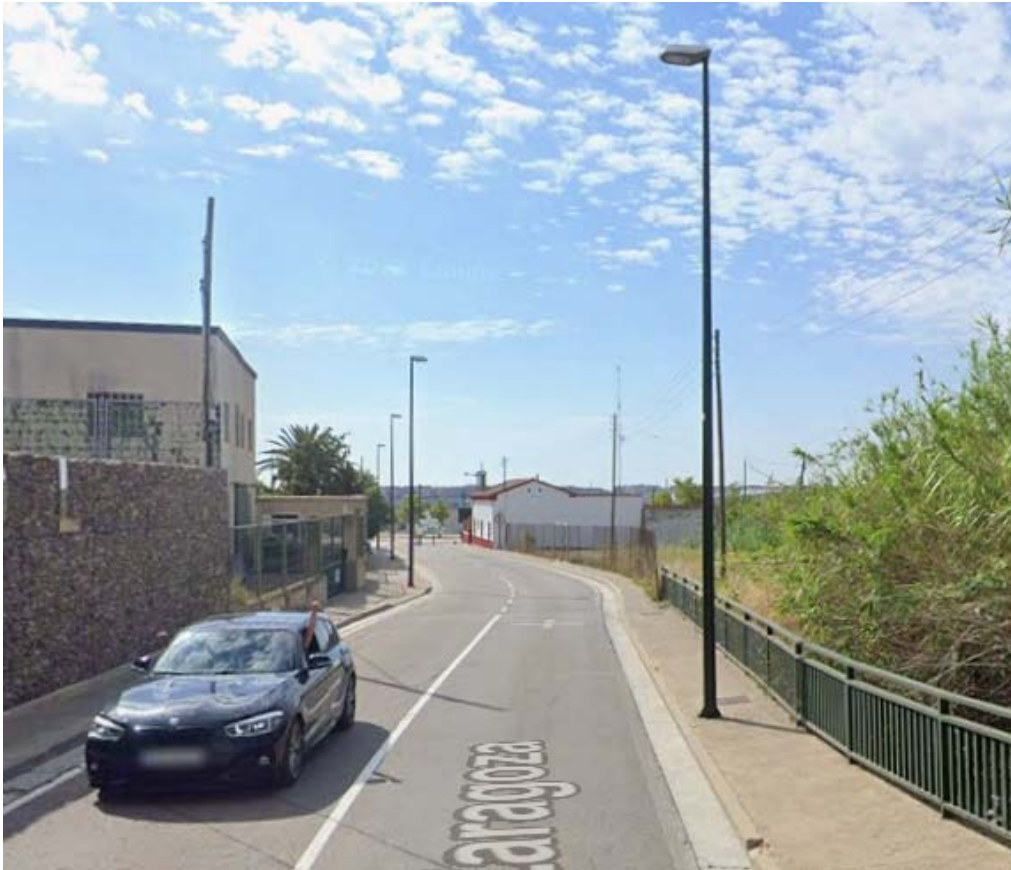
Imagen 12. Tramo 6. Luminarias tipo vial en columna metálica a 8 m.
