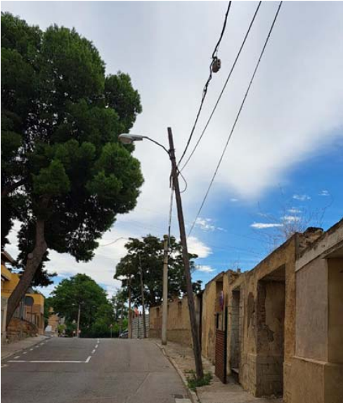
Imagen 5. Calle Mayor, tramo 1 con luminarias en fachada o poste de madera y hormigón.
