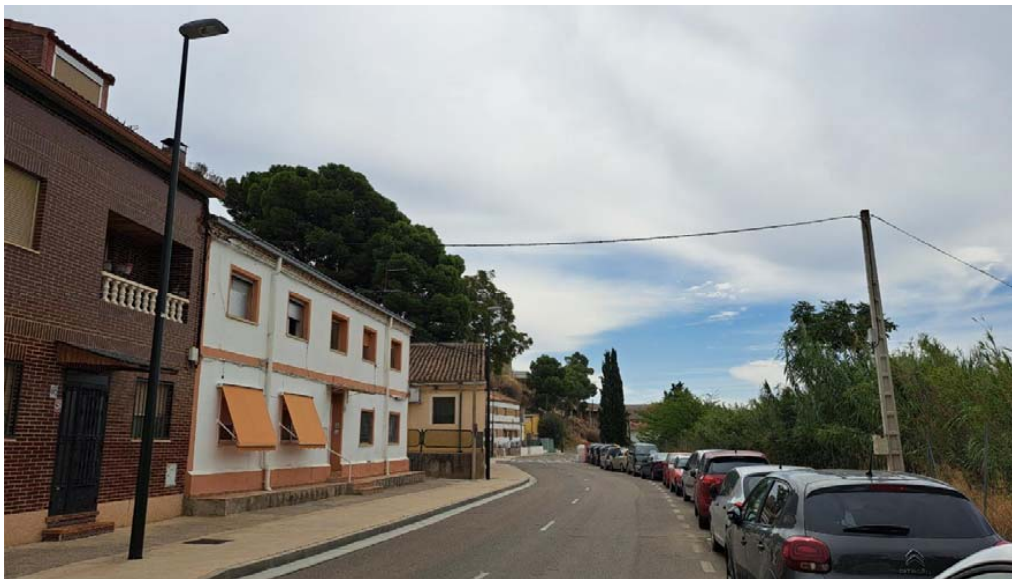
Imagen 9. Tramo 3. Luminarias en poste metálico a 8 metros de altura y canalización subterránea.
