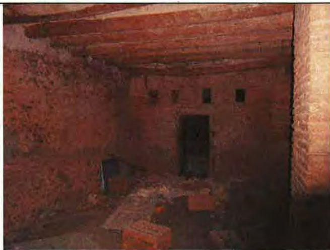
Forjado techo sótano. Hundimiento en zona vestíbulo
