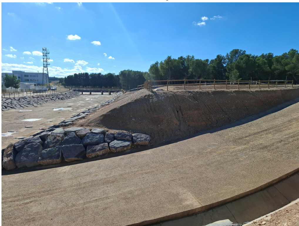
Talud de la Zona 2. A revegetar.
