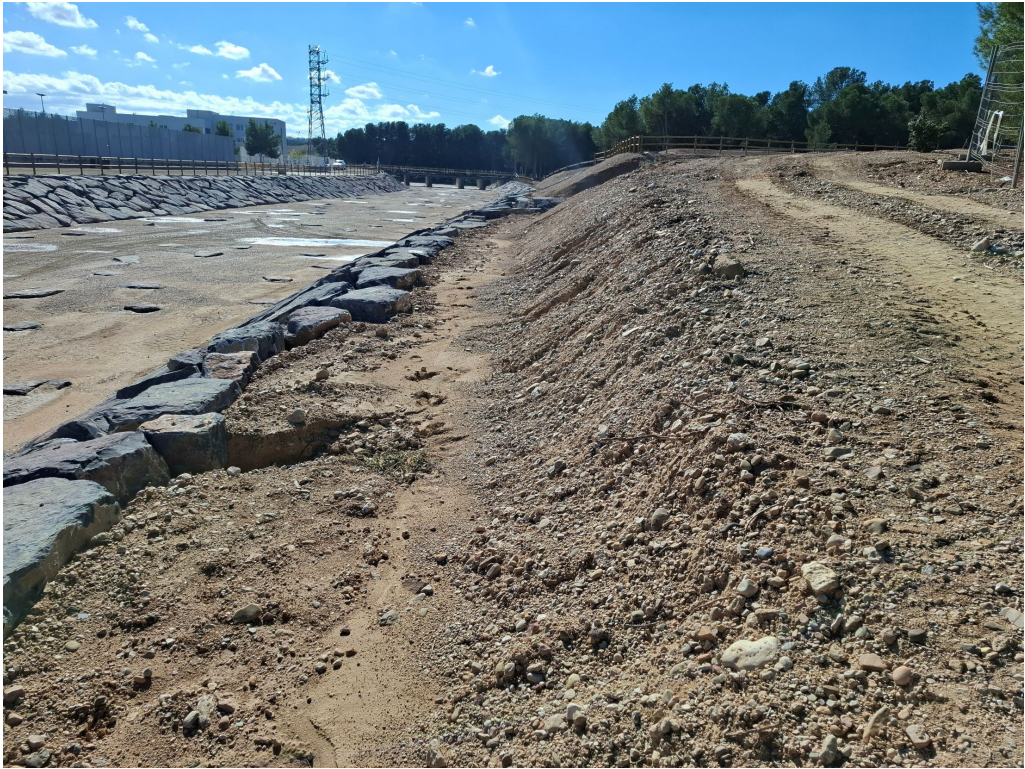
Talud de la Zona 1. A revegetar.
