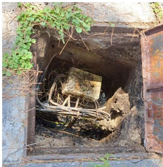
Imagen 10. Interior de arqueta en parque junto a calle Jesús y María.
