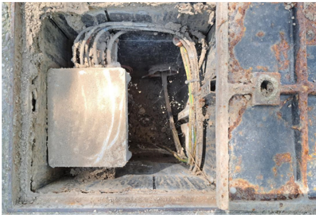
Imagen 7. Interior de arqueta en parque junto a calle Jesús y María.
