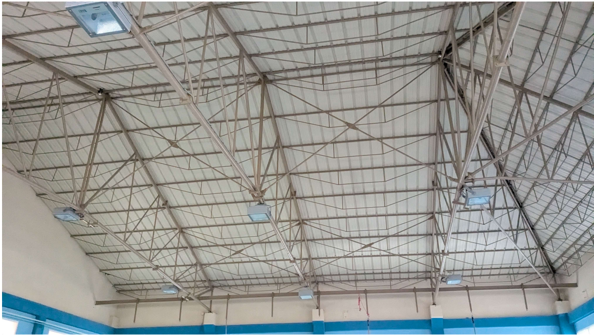
Focos sobre gimnasio
