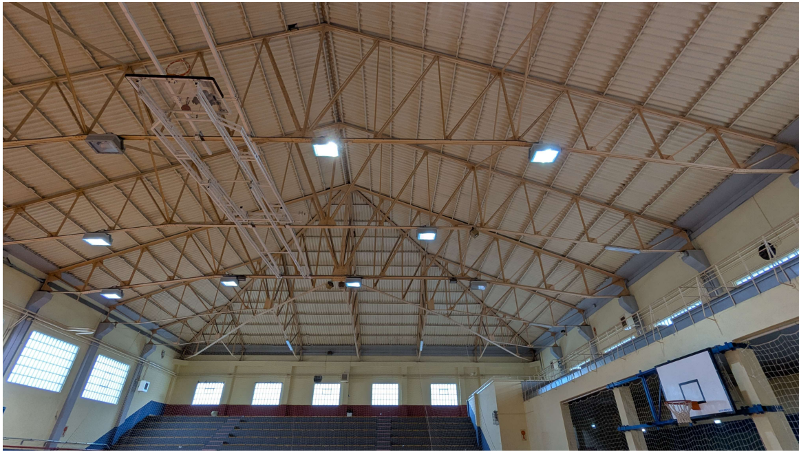
Focos sobre pista deportiva
