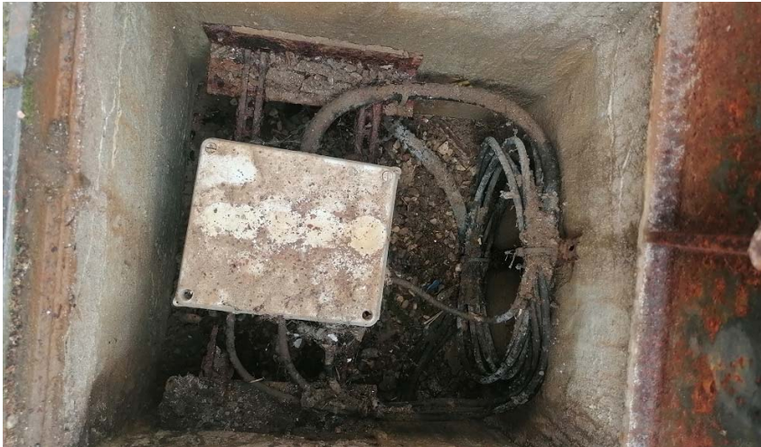
Imagen 7. Interior de arqueta en calle de Enmedio - plaza de España.
