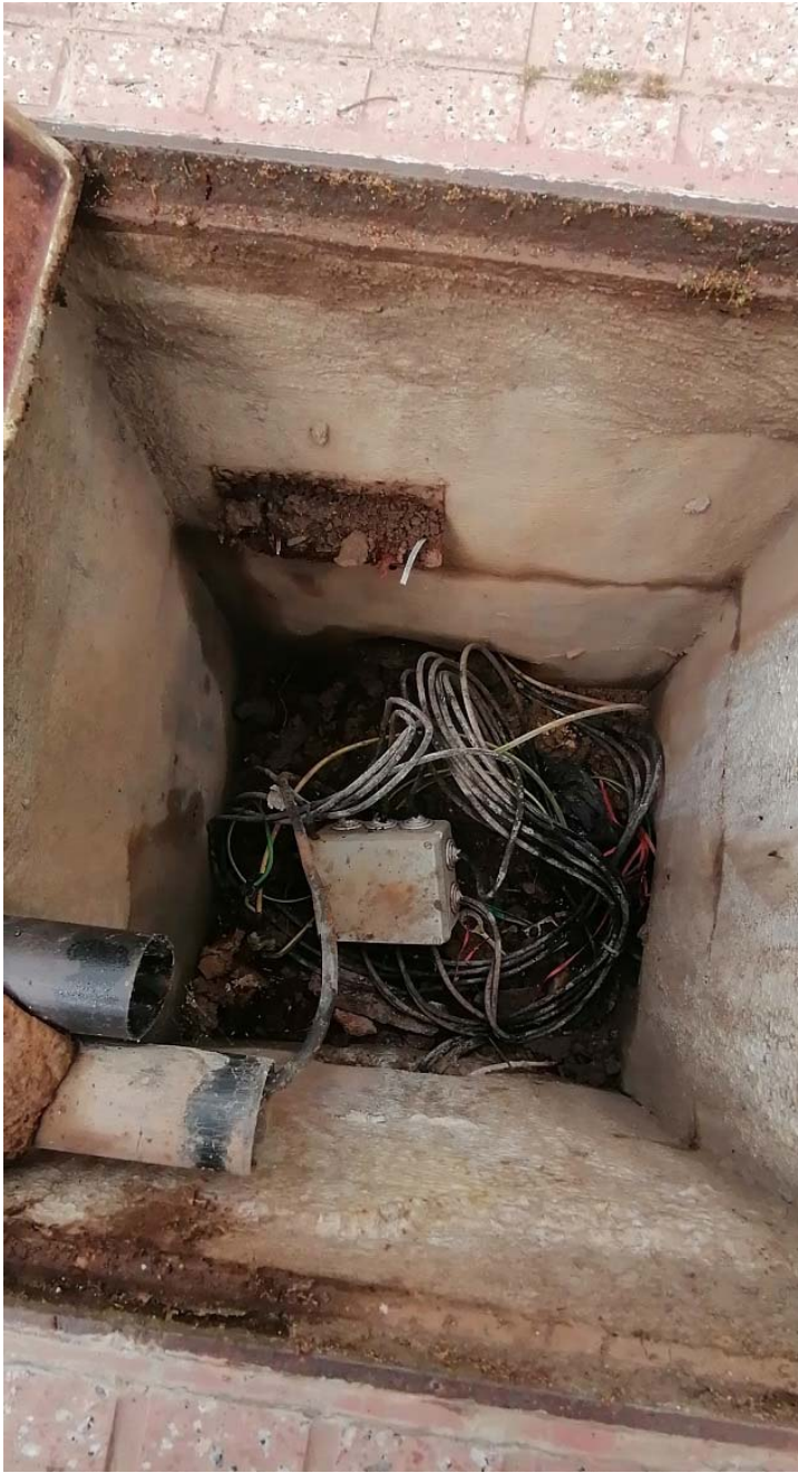
Imagen 9. Interior de arqueta en plaza de España, luminaria Z3-152-161.
