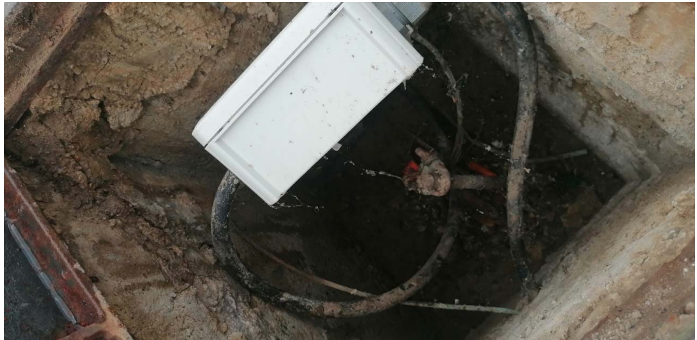
Imagen 13. Plaza del Carmen. Arqueta luminaria central Z3-152-072.
