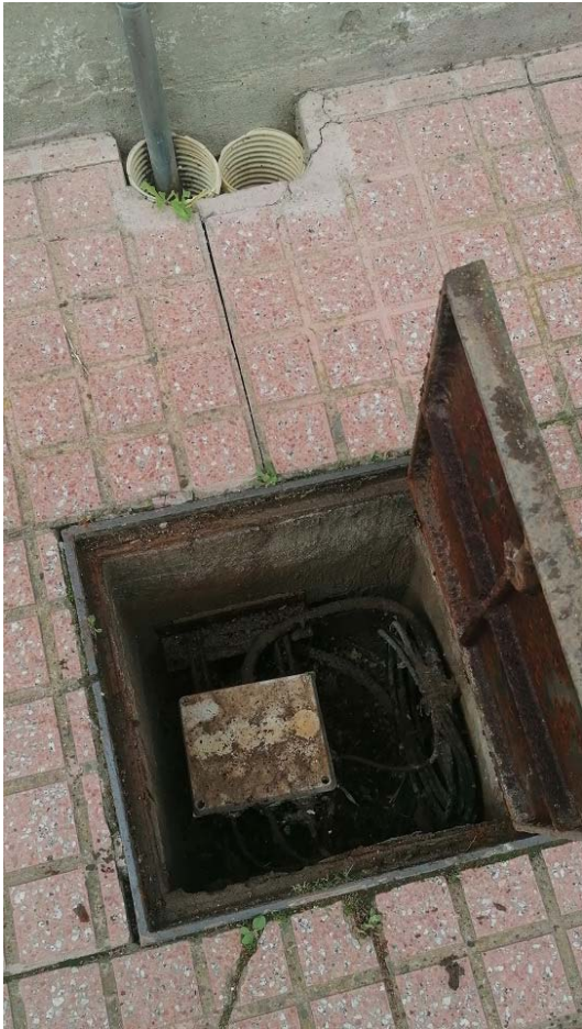
Imagen 6. Interior de arqueta en calle de Enmedio - plaza de España.
