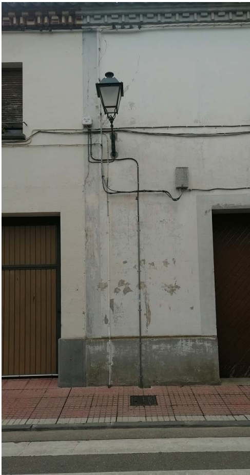
Imagen 5. Plaza de España. Luminaria perimetral ubicada en fachada de calle de Enmedio. Paso subterráneo – aéreo.
