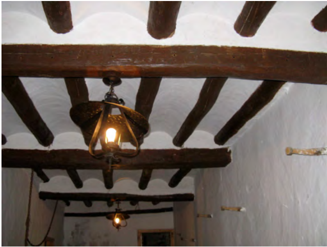
Techo pasillo distribuidor derecho
