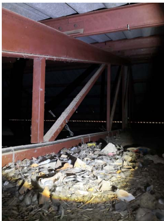
Vista del estado de la estructura metálica de la cubierta del pabellón
