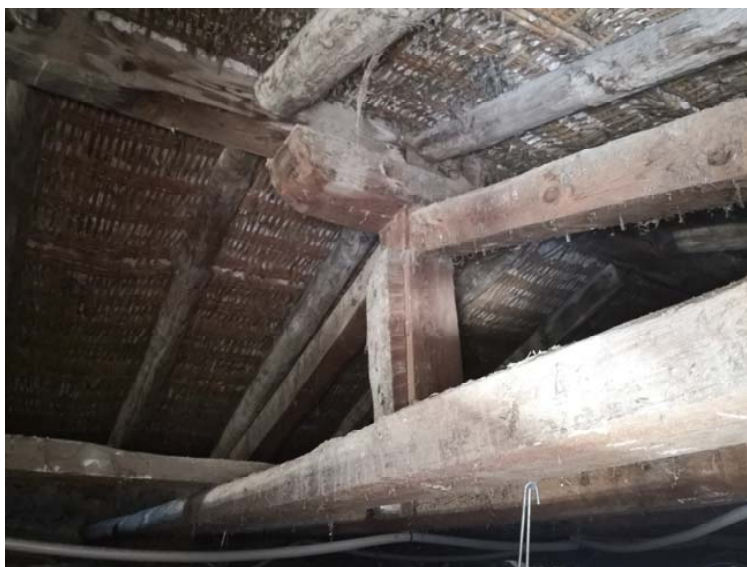
Vista estado de la estructura de cubierta del Centro Cívico
