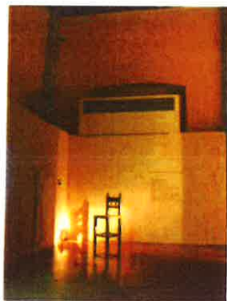
Módulo de sistema de climatización
