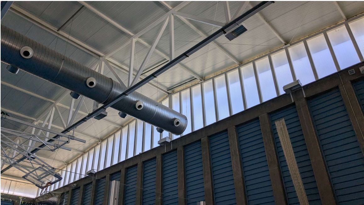
Focos sobre pista deportiva
