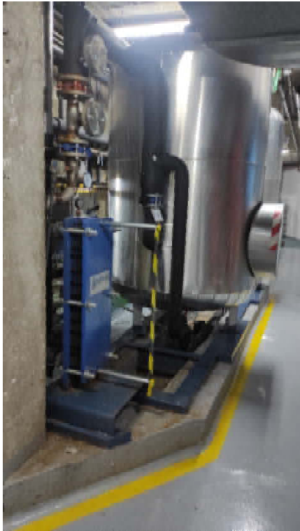
(FOTO 2 UBICACIÓN DEL INTERCAMBIADOR DE PLACAS)
