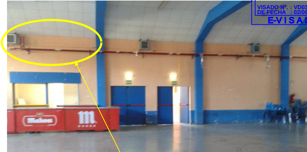
Zona apertura de cerramiento para paso de conductos de impulsión y retorno visto desde el interior
