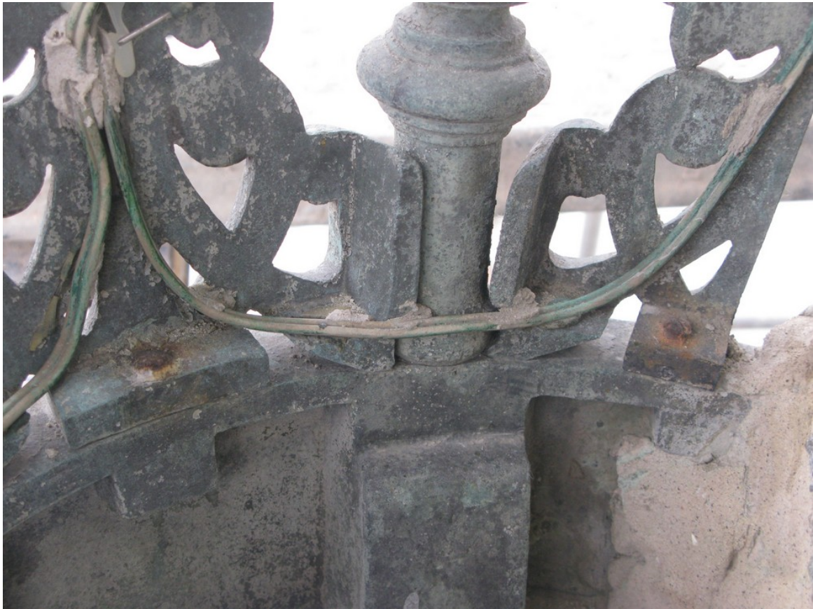
Cableado del sistema anti-aves.
