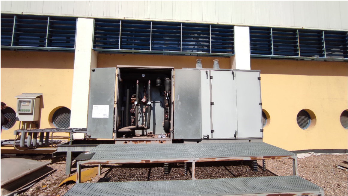
Foto 1 (Ubicación de la UTC y el armario hidráulico)
