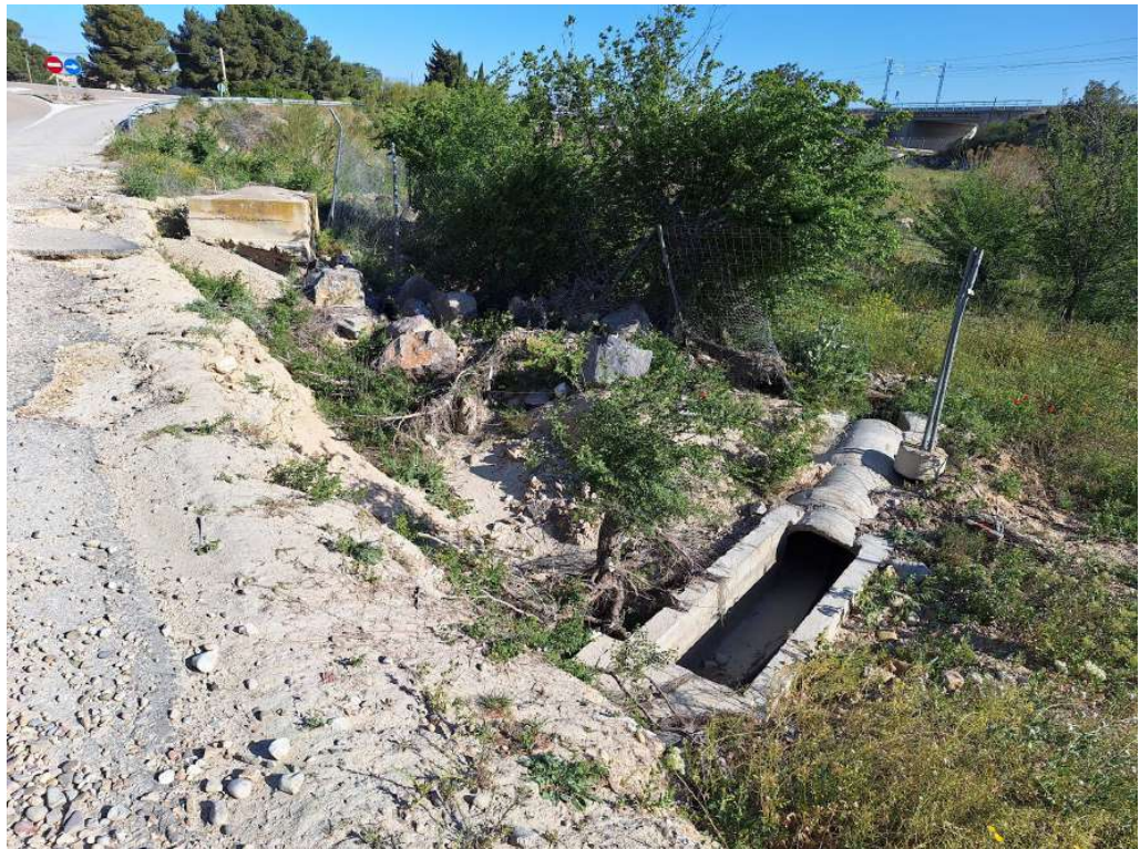
Afecciones en la carretera de acceso a INSIDER por la libre circulación del agua.
