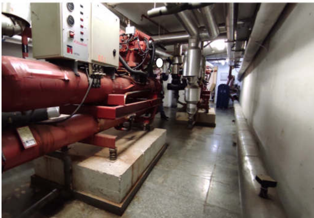
( FOTO 3. VISTA GENERAL DE LA SALA DE MAQUINAS)
