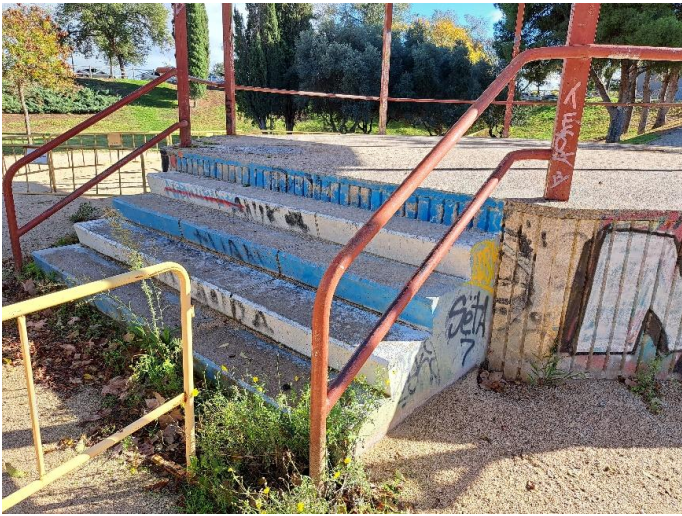
Escaleras de acceso a la plataforma. Fuente: EUROTEC.
