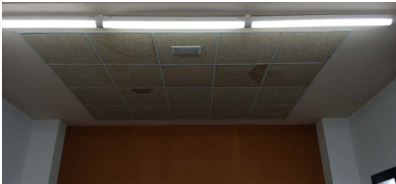
( Foto 1. Zona donde esta ubicada la unidad de conductos)
