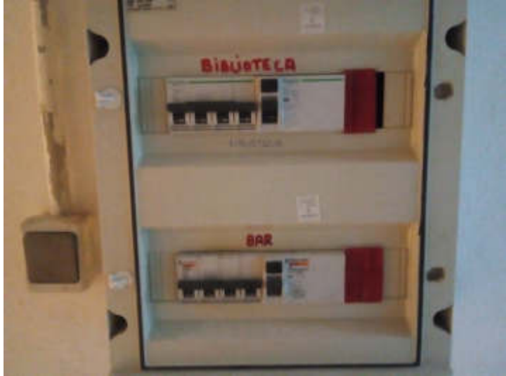
Foto 6 ( Cuadro sala de maquinas)
