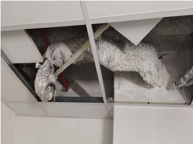
Tubo perdido en falso techo.
