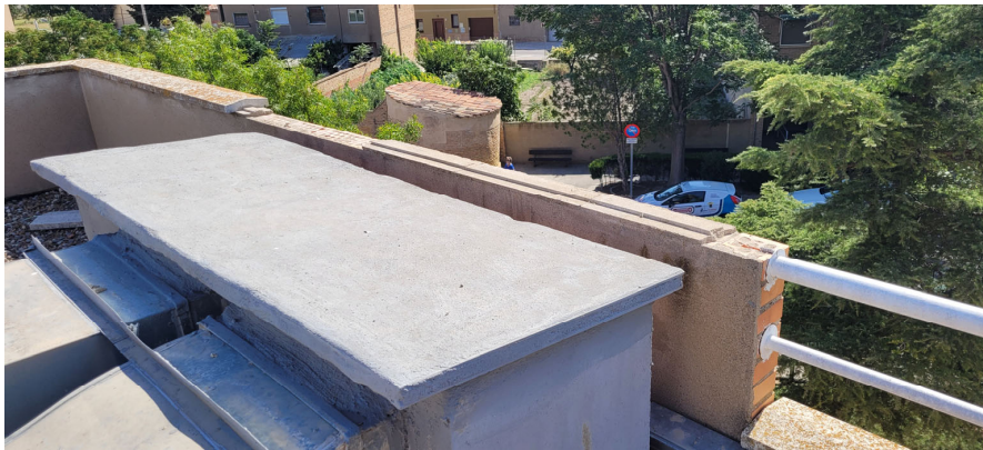
Desprendimiento de albardillas. Revisión y sujeción.
