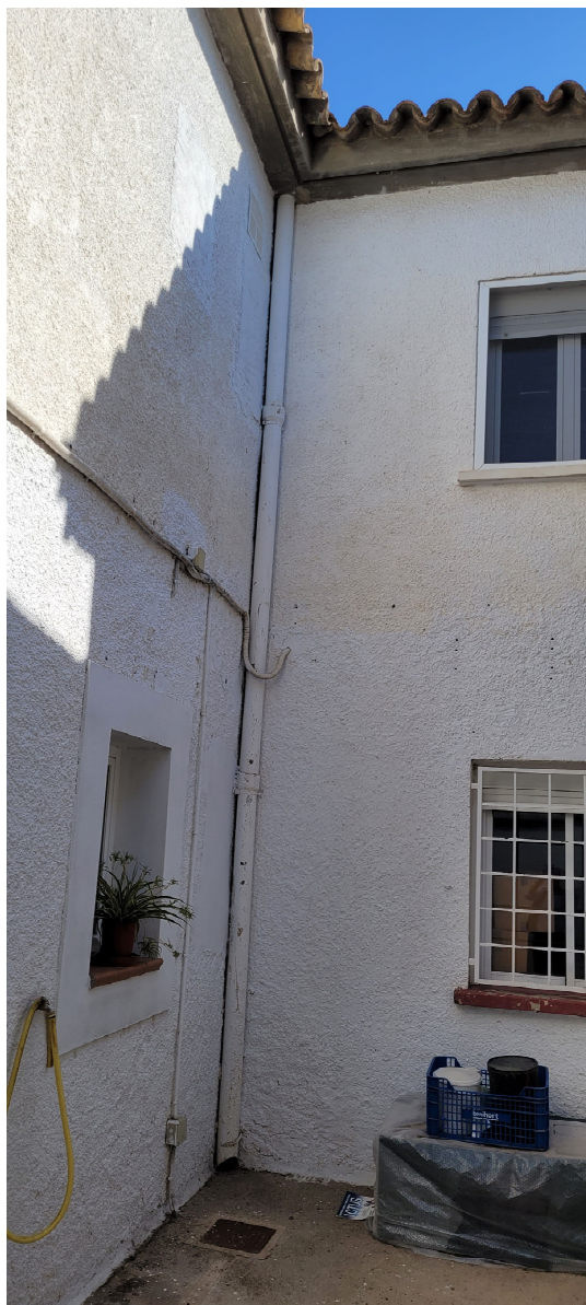
Patio de luces interior. Instalar escalera de seguridad.
