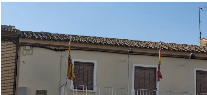
Retirar línea de vida no homologada e instalar nueva
