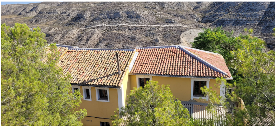
Vista general de cubiertas. Retirar líneas de vida no homologadas e instalar nuevas.
