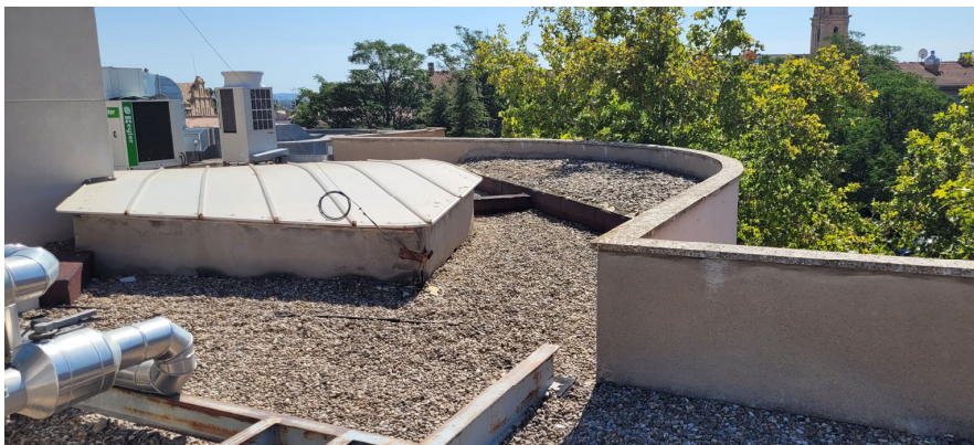
Antepecho circular más bajo. Proteger zona con vallado sobre forjado a 1,10 m.
