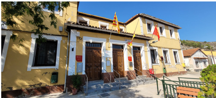
Cubierta sobre entradas. Instalar línea de vida bajo la fila de ventanas.
