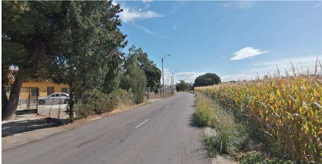
Imagen 5. Luminarias existentes en Camino de Pinseque.
