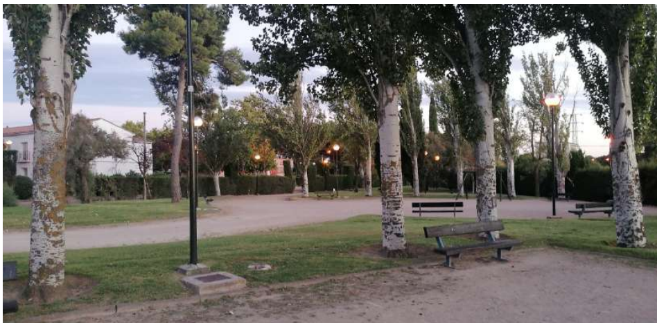
Imagen 7. Luminarias existentes en parque entre avda. San Gregorio y calle Cristo Rey.
