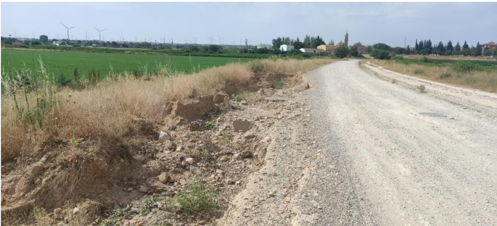
Ilustración 2 Zona dañada por la crecida
