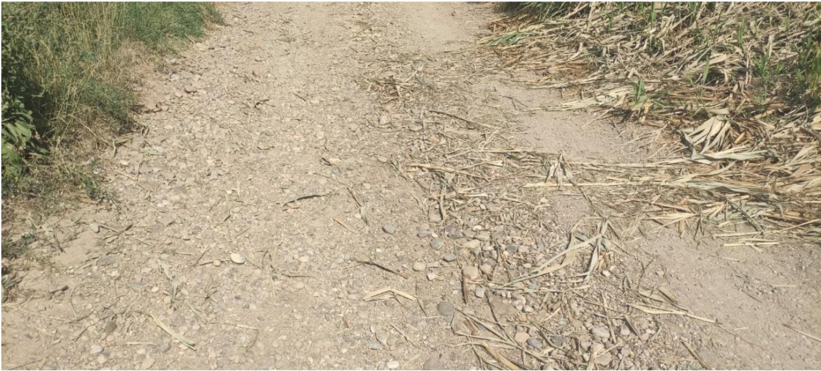
Ilustración 4 Zona afectada por desprendimientos de material
