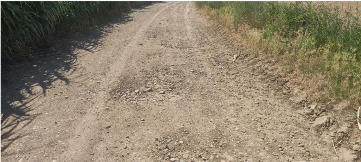
Ilustración 3 Zona bacheada en mitad de tramo
