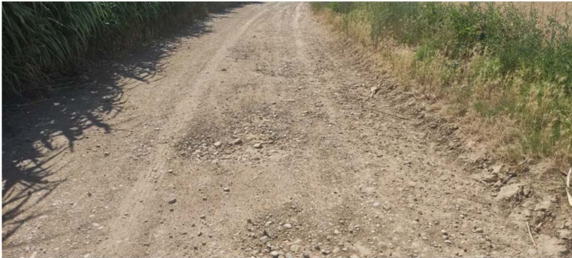
Ilustración 3 Zona bacheada en mitad de tramo
