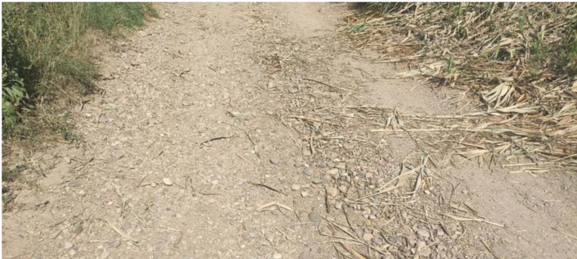
Ilustración 4 Zona afectada por desprendimientos de material
