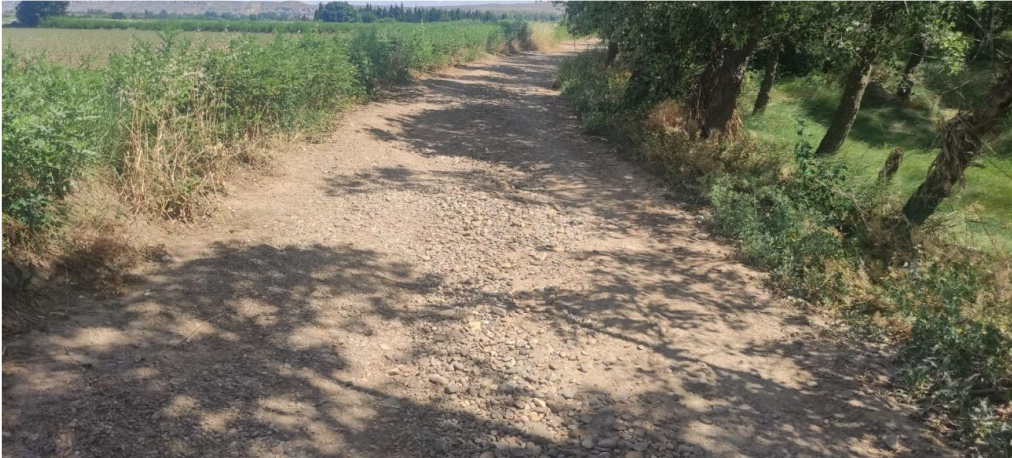
Ilustración 4 Zona afectada por desprendimientos de material y baches
