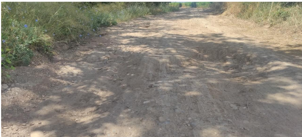
Ilustración 3 Zona bacheada en final de tramo
