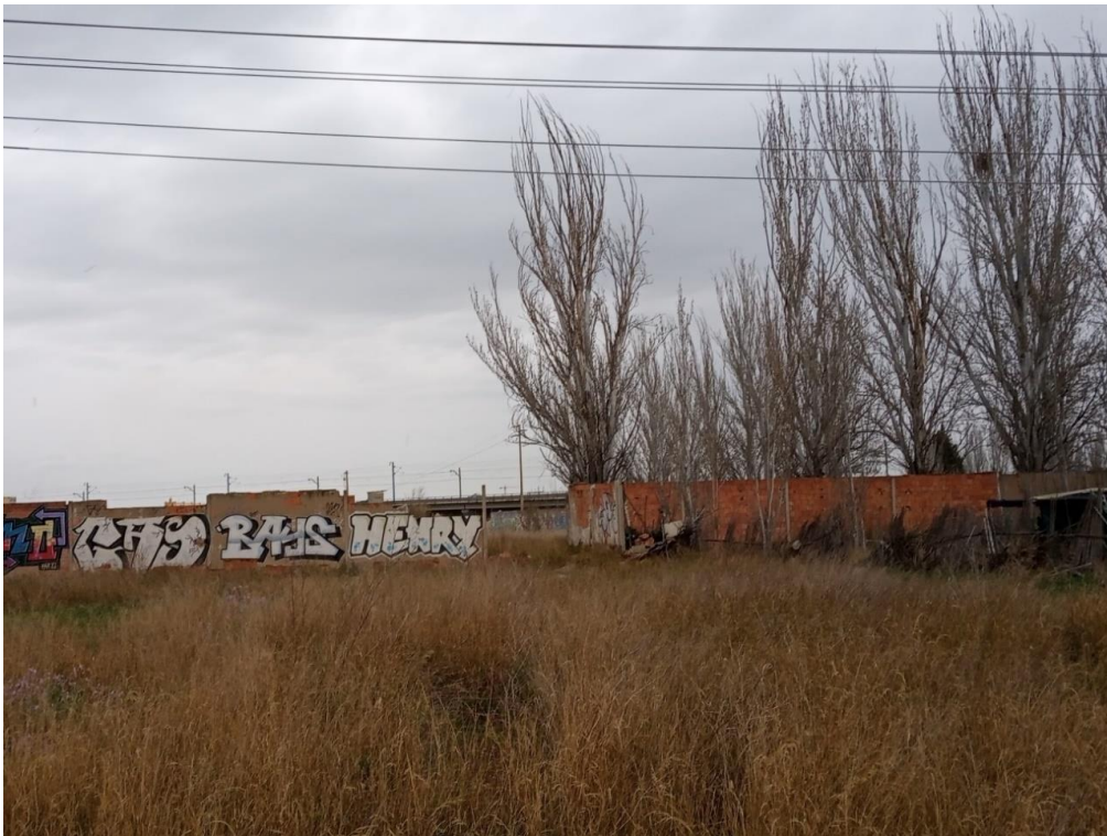
Detalle del muro semiderruido en el lateral norte.
