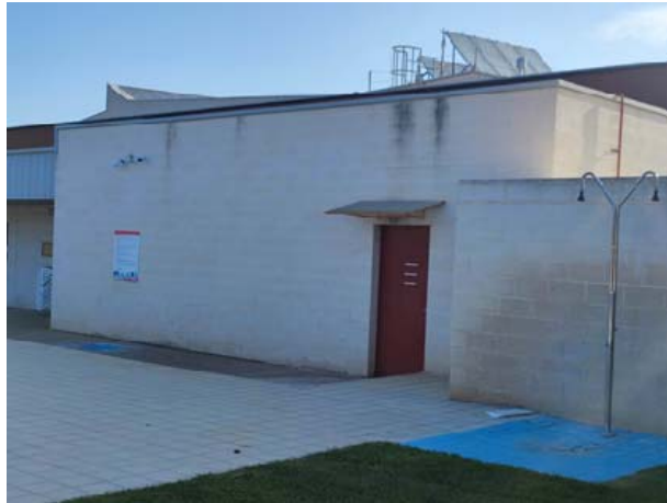
Puerta que da acceso al interior del edificio por el que se accede a su vez a cubierta.
