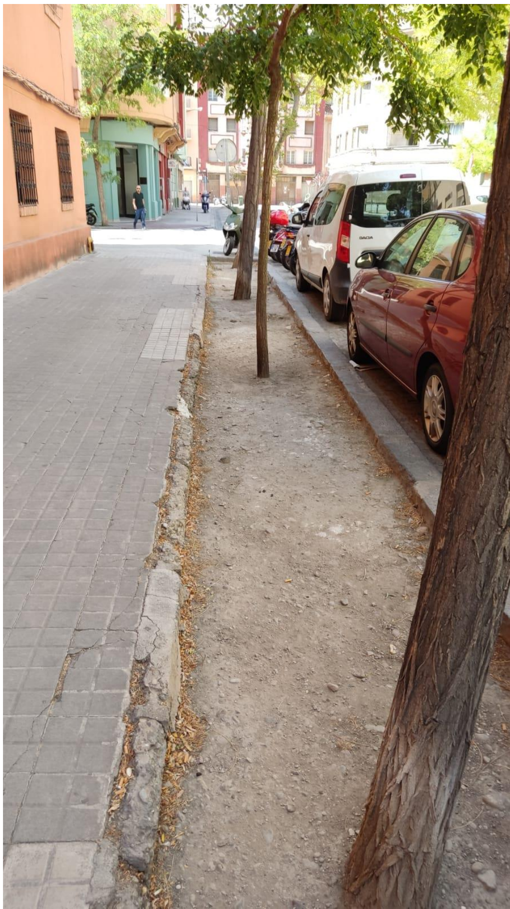
Foto nº 3.- Bordillos jardineros en mal estado en acera sureste
