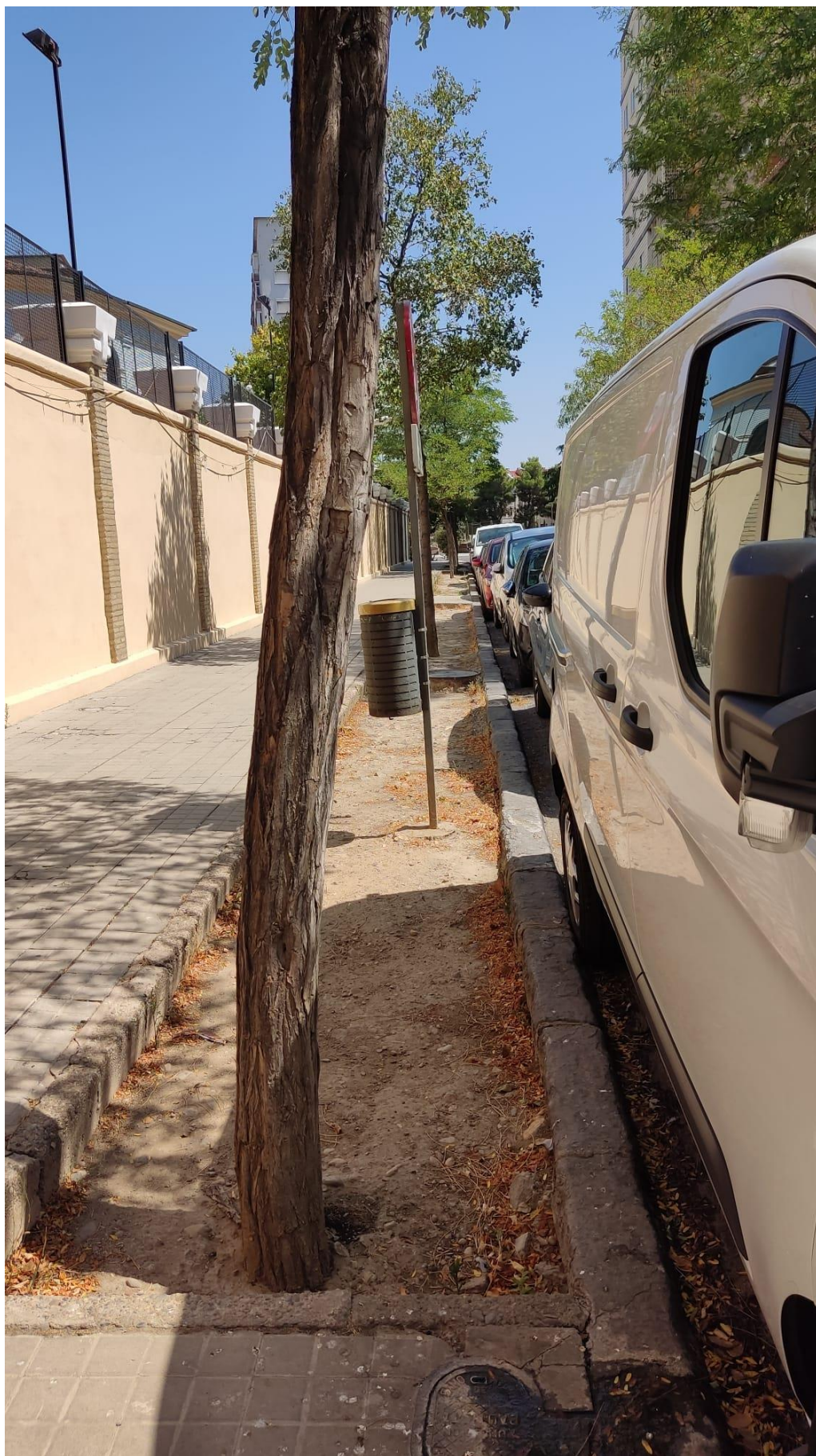
Foto nº 1.- Boca de riego en servicio en acera noroeste
