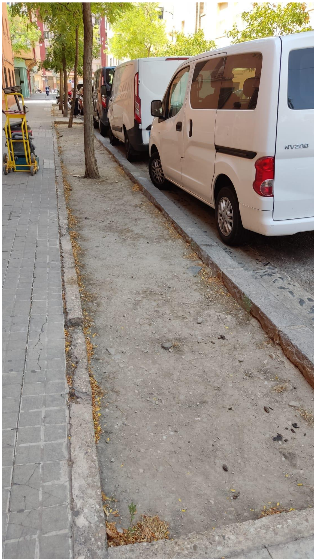
Foto nº 7.- Vista en primer término de fila de loseta a demoler junto a platabanda
