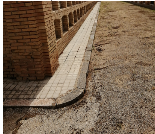
Pavimento marcado por escorrentías
