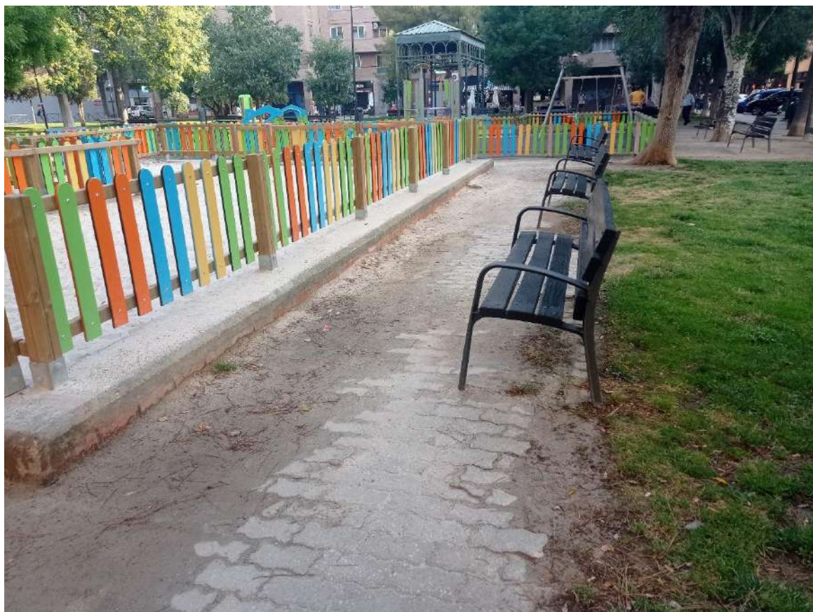
Foto 7.- Zona de adoquín de hormigón a reponer.
