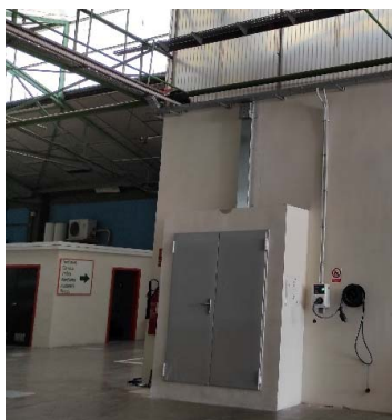
( FOTO 4. CUADRO ELECTRICO)
