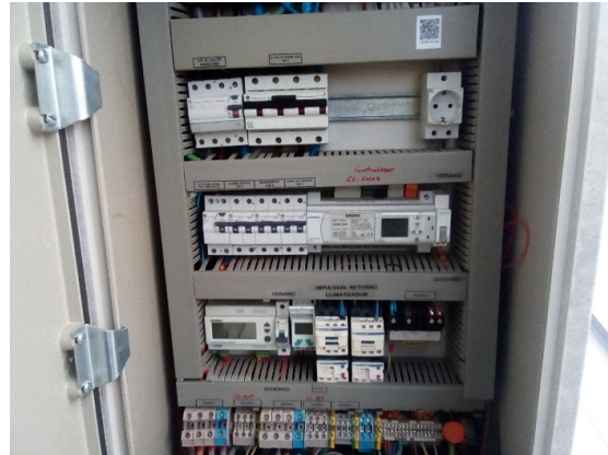
Foto 3. ( Cuadro electrico de potencia en Terraza)
