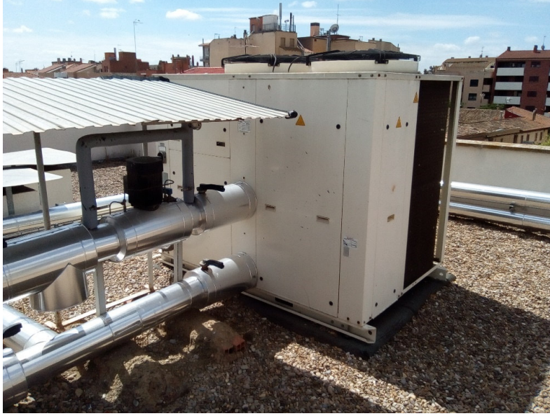
Foto 1. ( Bomba de calor HITECSA)
