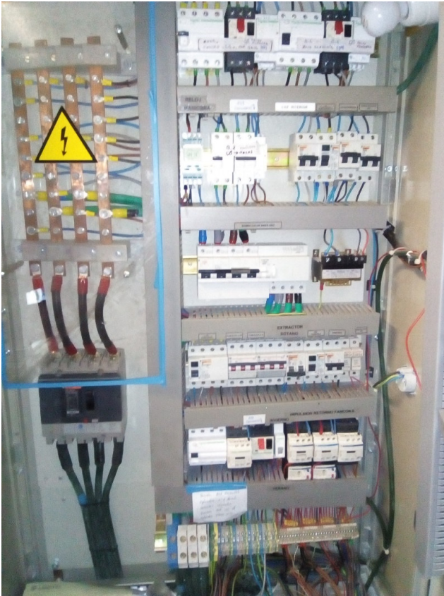
Foto 4. ( Cuadro electrico de potencia en Sotano -1)
