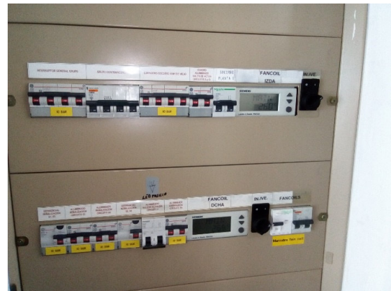
Foto 5. ( Cuadro electrico de potencia en Pasillo)
