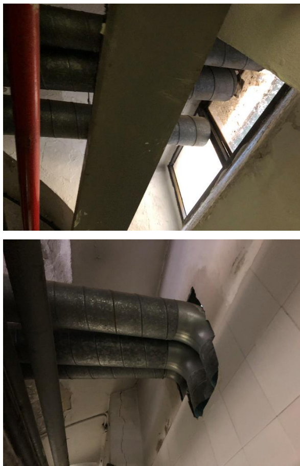
Conductos ventilación almacén/pasillo (vista pasillo)
