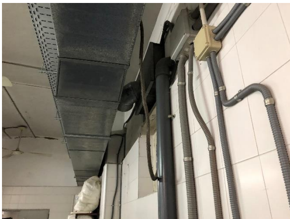
Ventana y conducto ventilación almacén/pasillo (vista desde almacén)
