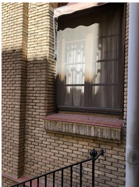
Ventana a demoler
