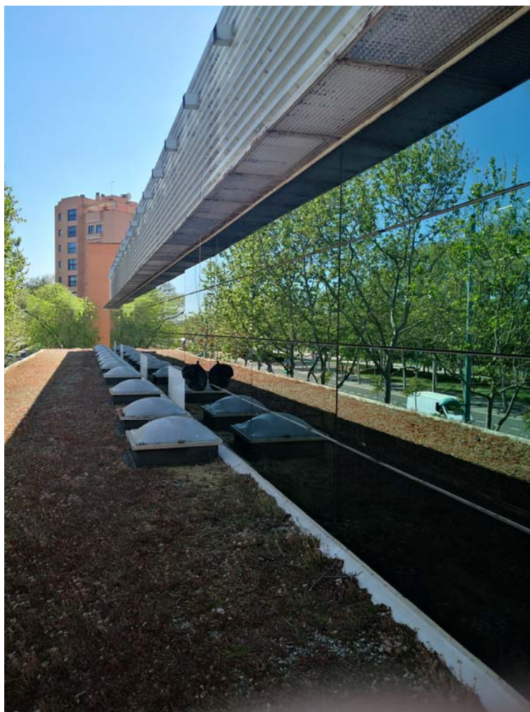
Cubierta plana en mal estado de conservación, y estructura de voladizo metálico donde se anclará la línea de vida tipo Overhead.
