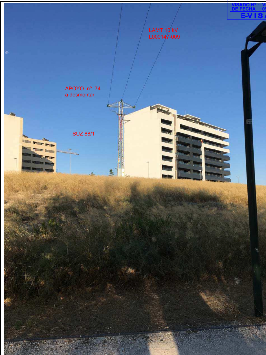
FOTO 7. Línea aérea de media tensión (10 kV). Apoyo nº 74 de conversión aéreo-subterráneo y línea a desmontar
