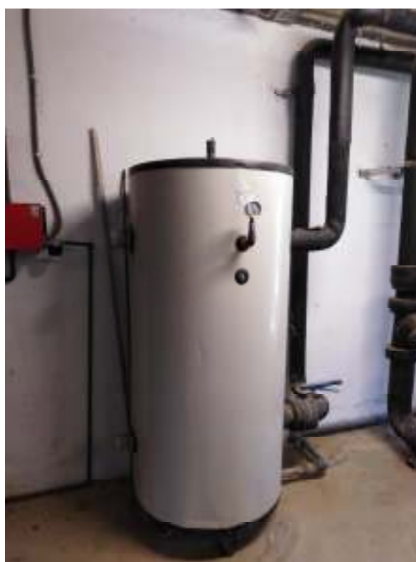
Depósito inercia existente
