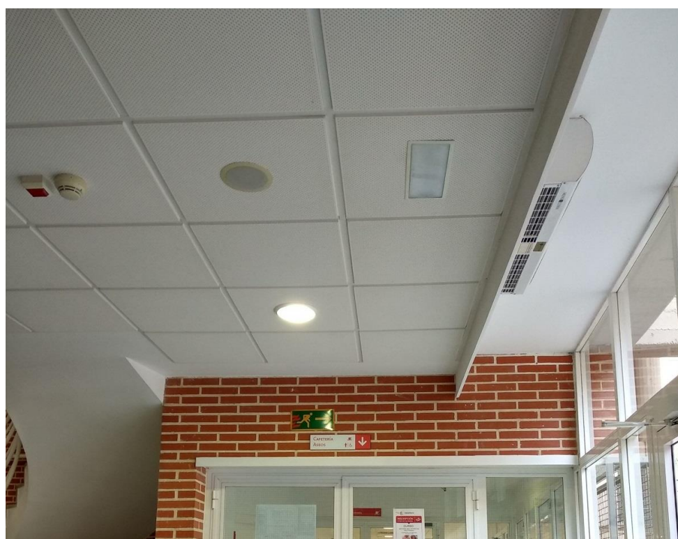
PUERTA EN ACCESO PRINCIPAL (FALSO TECHO AFECTADO)
