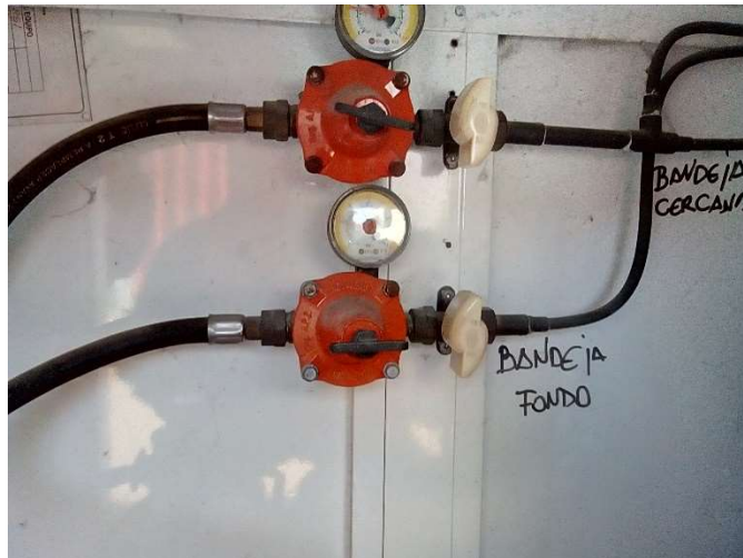
Foto 4.( Punto de conexión Fase gas)
