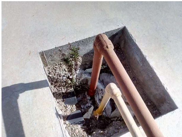
Foto 2. (Punto de conexión en Centro de Almacenamiento)
