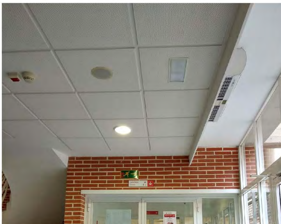
PUERTA EN ACCESO PRINCIPAL (FALSO TECHO AFECTADO)
