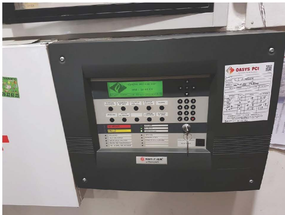
CENTRAL DE INCENDIOS
