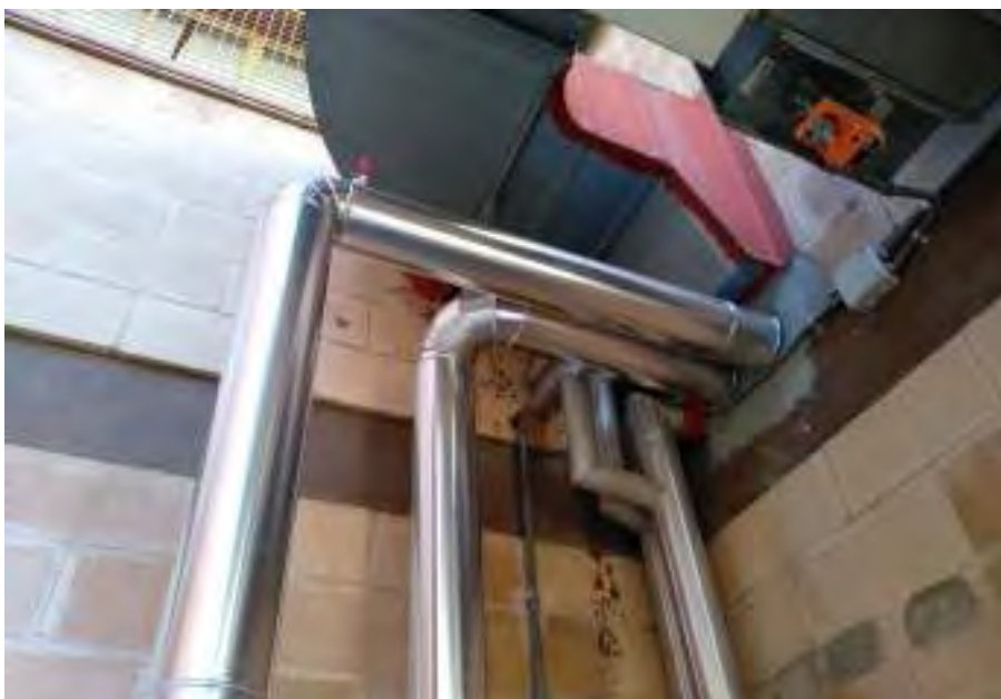
Sistema de distribución. Patio trasero.
