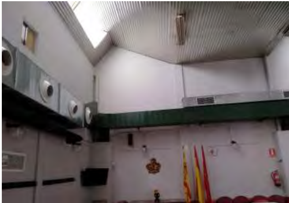
Sistema de distribución. Salón de actos.
