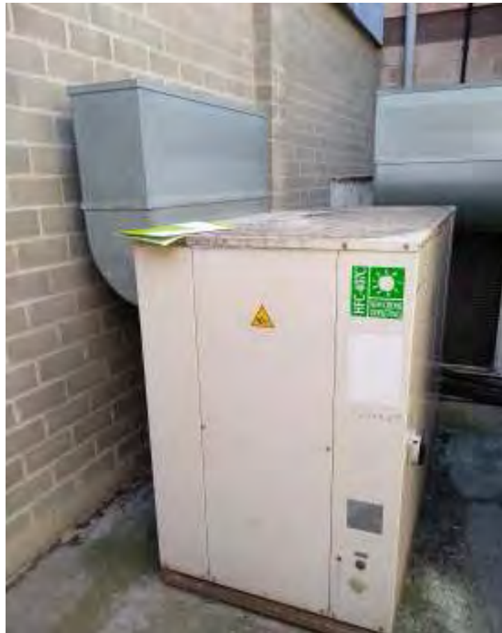
Equipos actuales. Patio trasero.
