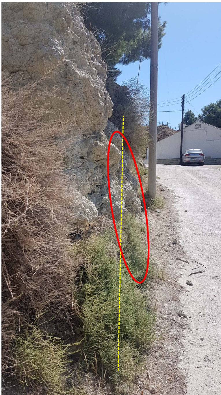
Vista en la posición teórica del muro a construir y detalle de la zona a reperfilar.
