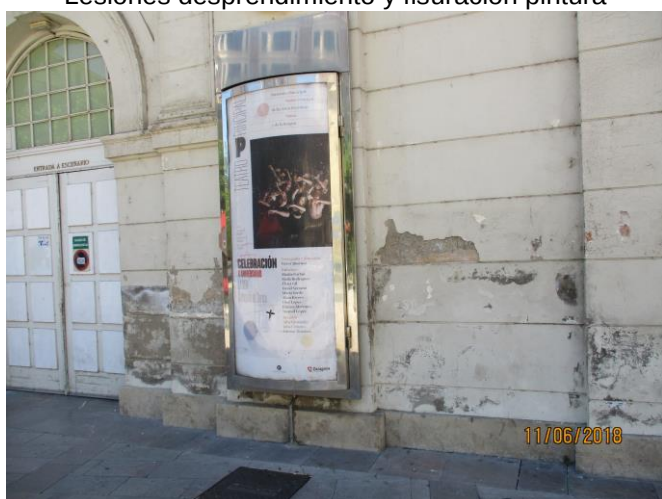
Lesiones humedad capilaridad
