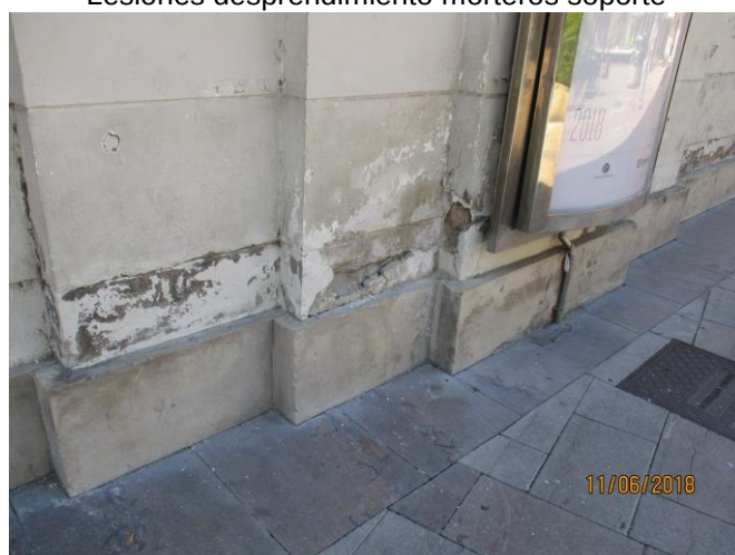
Lesiones disgregación mortero. Capilaridad
