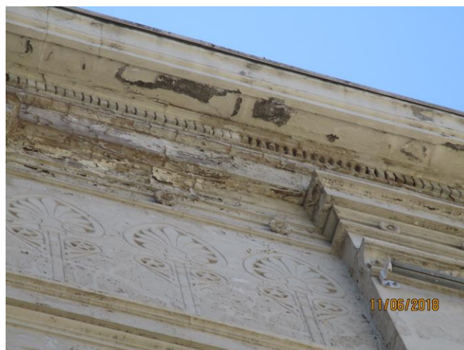
Lesiones filtración agua lluvia
