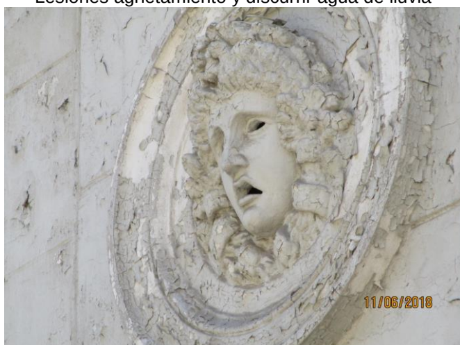
Lesiones desprendimiento y fisuración pintura
