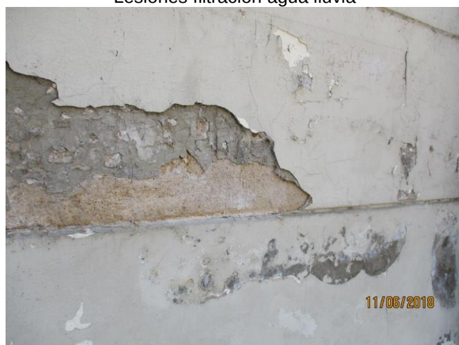
Lesiones desprendimiento morteros soporte
