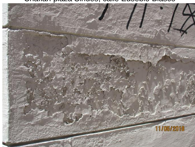
Lesiones por desprendimiento de pintura
