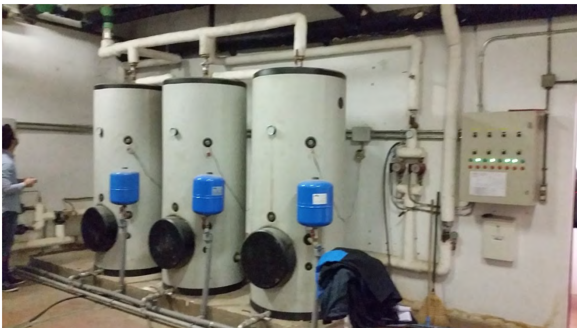
DEPOSITOS ACS EXISTENTES
