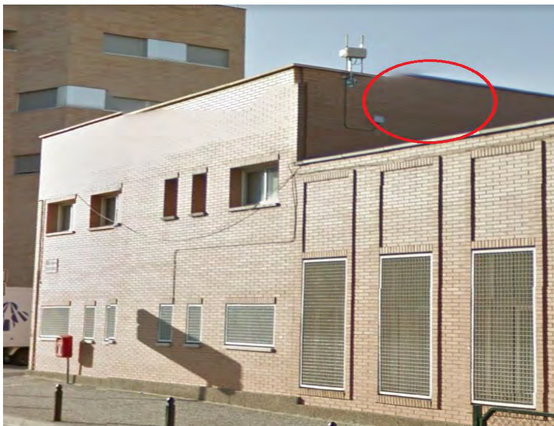
Parte de fachada por donde entrarán en el edificio los conductos de ventilación
