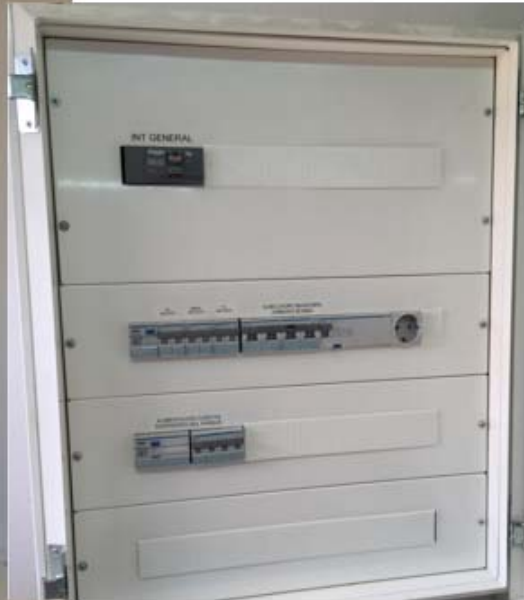
Cuadro de distribución
