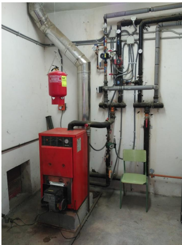
VISTA INTERIOR SALA DE CALDERAS 1
