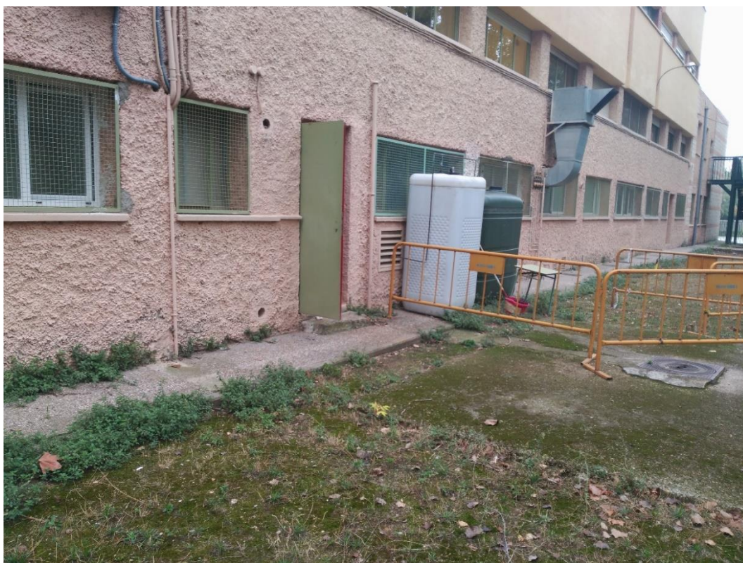
ACCESO DESDE EL EXTERIOR A SALA DE CALDERAS 2
