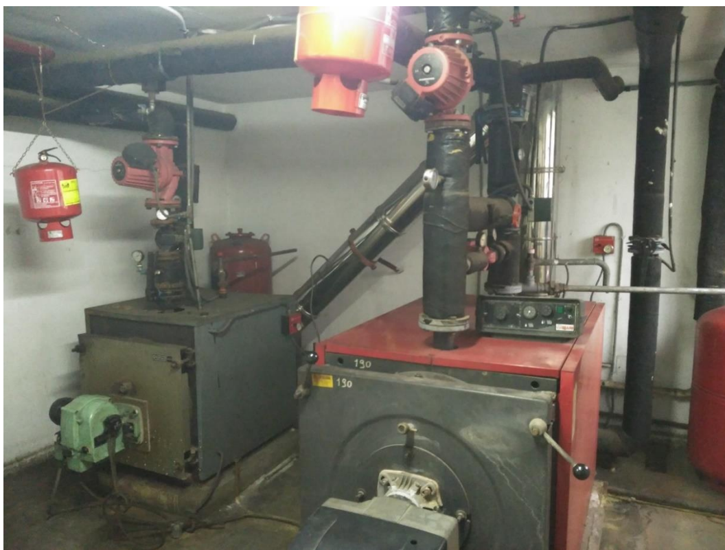
VISTA INTERIOR SALA DE CALDERAS
