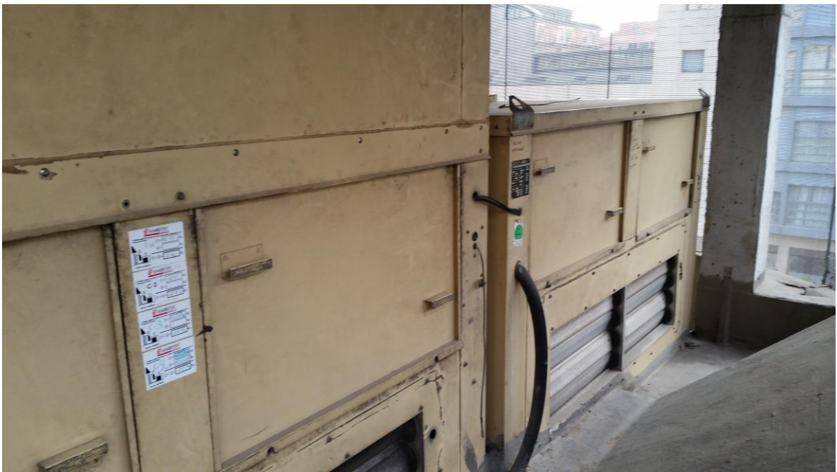
VISTA INTERIOR ALTILLO CON BOMBAS DE CALOR ACTUALES
