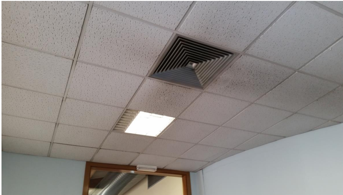
ZONA DE FALSO TECHO DONDE SE UBICARÁN UNA DE LAS UNIDADES DE CONDUCTOS Y UNO DE LOS RECUPERADORES DE CALOR.
