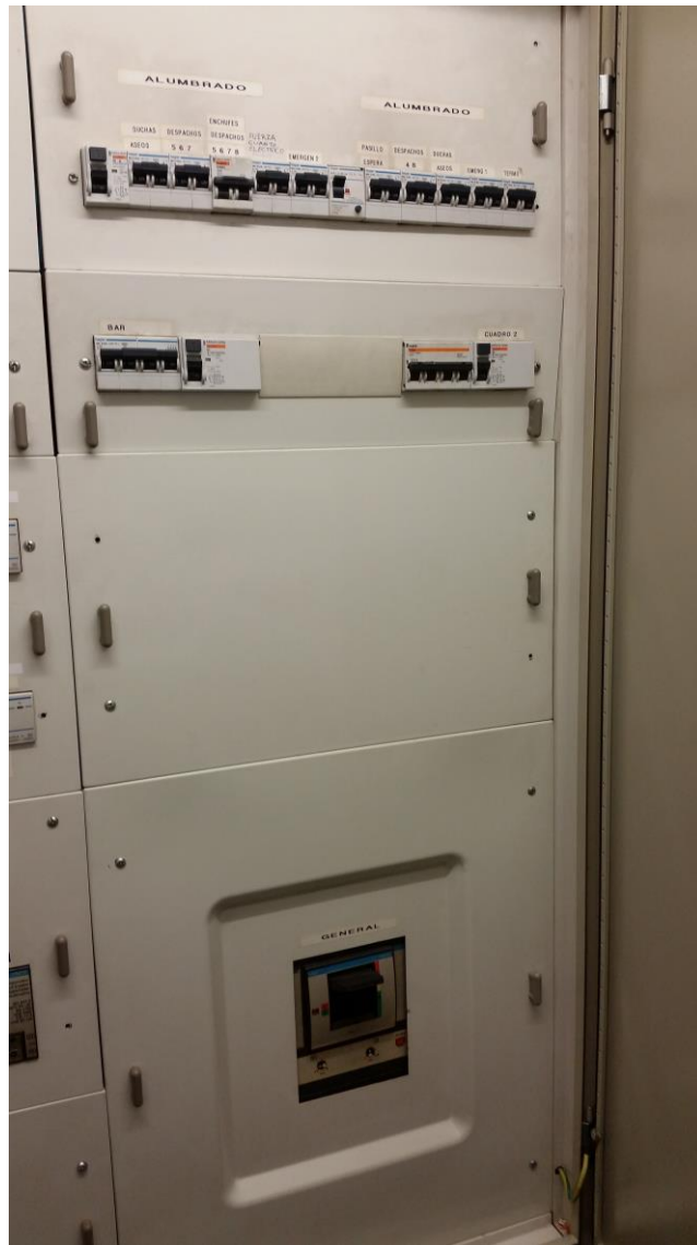
CUADRO ELÉCTRICO EXISTENTE
